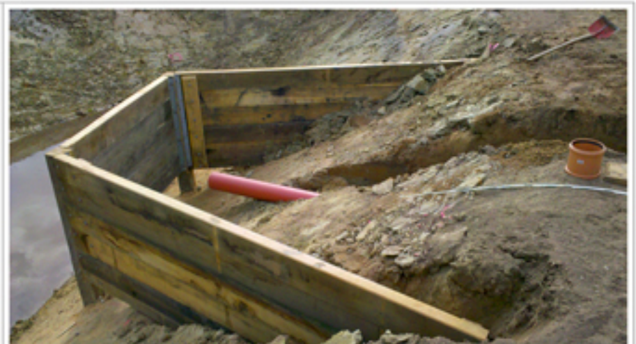
Feste Tauchwand, Straßeneinlauf, Regenrückhaltebeckens Diving Baffle Board, street water inlet, rainwater retention basin
