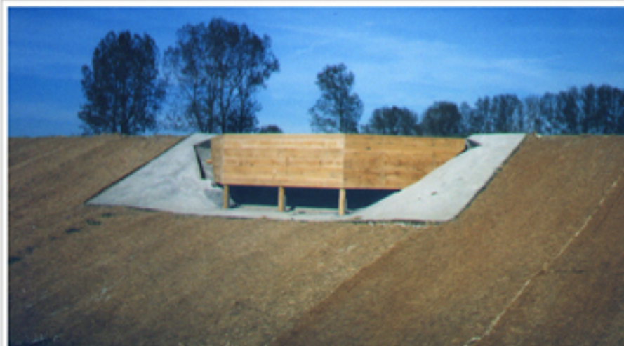
Feste Tauchwand, zum Schutz einer Überfallwand Diving Baffle Board, to protect a spillover weir
